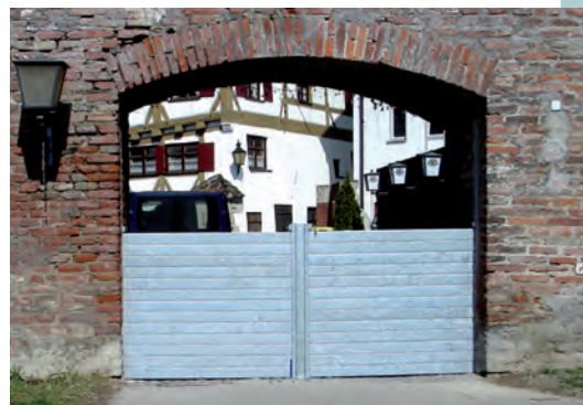
Vorbeugender Hochwasserschutz in Ulm – der Durchgang in der historischen Stadtmauer am Ufer der Donau kann bei Bedarf schnell und unkompliziert mit dem Stahlsystem abgeschottet werden.
