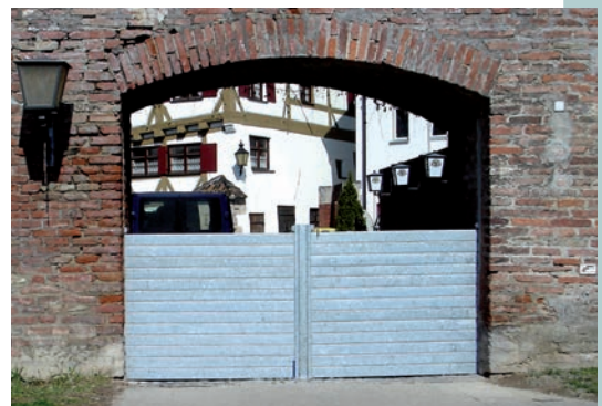
Vorbeugender Hochwasserschutz in Ulm – der Durchgang in der historischen Stadtmauer am Ufer der Donau kann bei Bedarf schnell und unkompliziert mit dem Stahlsystem abgeschottet werden.
